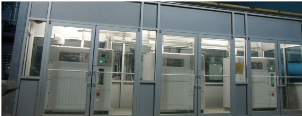
Úpravná vody Keokuk, Iowa, USA, rok instalace 2013 (řada Aquion MIOX Rio, kapacita výroby 27,4 – 136 kg/den ekvivalentu volného aktivního chloru)
