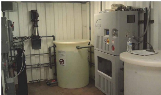
Dezinfekce vody Apple Valey, California, 2013 (Aquion MIOX Vault, kapacita 6,8 – 27,2 kg/d chloru)
