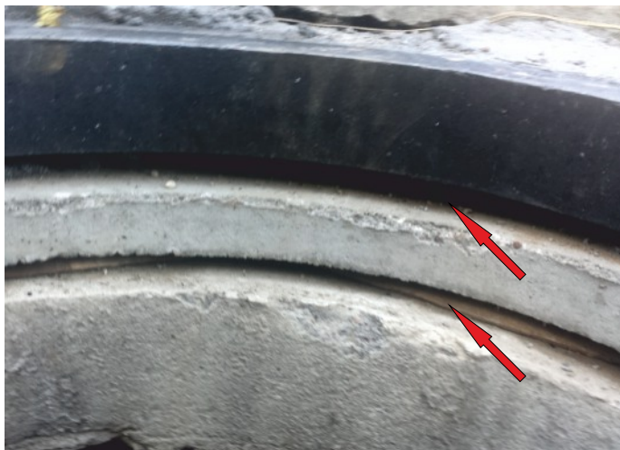
❶ Nepřijatelné provedení – nedostatek podpory pro vyrovnávací prstence a adaptéry. Zakončení nezajišťuje nosnost, těsnost a bezpečnost konstrukce!
