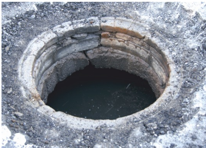
① Intenzivní opotřebení zhlaví šachty. Úplná degradace vyrovnávacích prstenců, betonové spojovací a vyrovnávací malty, praskliny krycí desky. Sanace není možná bez výměny poškozené krycí desky šachty.
