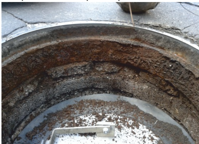
Degradace konstrukce podírající poklop. Betonové malty rozpadlé, prasklé vyrovnávací prstence. Nedostatečná únosnost a těsnost zhlaví šachty.
