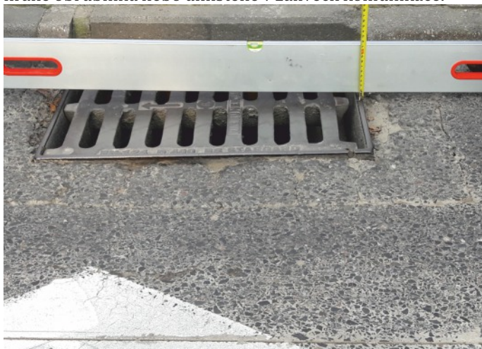
Ověření technického stavu vpusti. Zapadnutá vpust. Pokles roštu v rámu.
