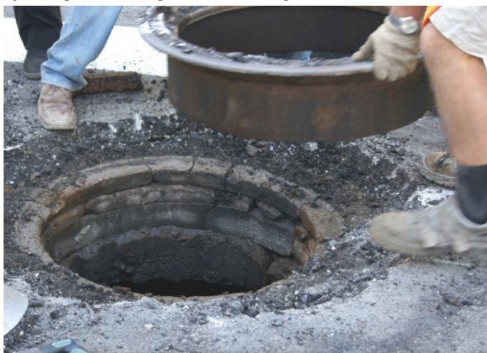
Odstranění rámu samonivelačního poklopu s menším povrchem rámu (cca 1 600 cm 2 ) namontovaným přímo na betonové prvky! Nepříznivé podmínky prostředí. Životnost 1,5 roku.
