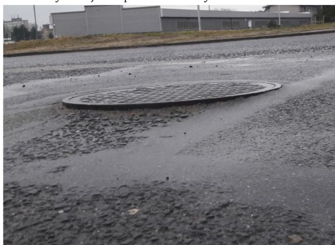
Poklop vyzdvihnutý nad povrch vozovky v důsledku jejího poklesu
