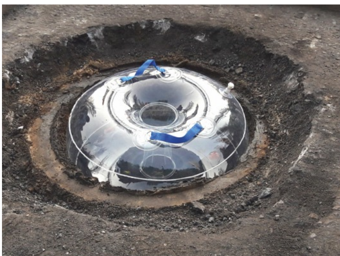
Před zahájením demoličních prací může pneumatické bednění sloužit jako ochrana před znečištěním kanalizace.
