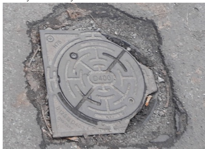
ⓘ Teleskopický poklop šachty DN315 poškozený z důvodu nedostatku rovnoměrné a trvalé podpory.
