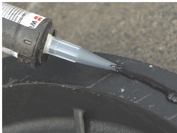
Aplikace těsnícího polymerového tmelu a spojovací hmoty na dolní povrch rámu poklopu
