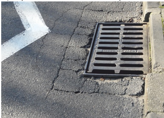
Porušené okolí uliční vpusti. Nevhodná poloha – cyklické poježdění autobusů. Povrchové trhliny se vyvinuly díky nedostatečnému podložení vpusti a díky netěsnostem v tomto podložení.
