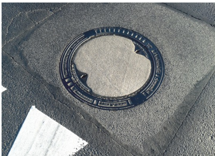
Plovoucí poklop uložený pomocí vyrovnávacích prstenců T1/700 a vodícího adaptéru TXS/710/80 umožňující dobrou instalaci samonivelačního poklopu. Legnica silnice S-3, křížový pojezd po poklopu, zatížení na pás Kr. 4. (336-100 pojezdů jízdního pruhu/den osa 100 kN) po 6 letech provozu.
