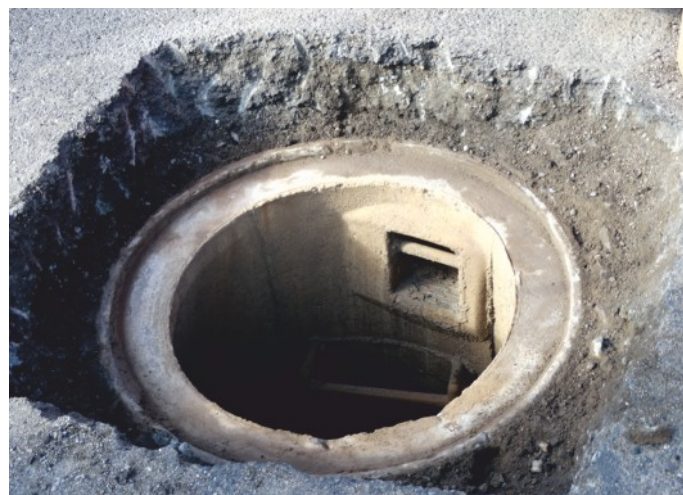
① Intenzivní opotřebení zhlaví šachty. Úplná degradace vyrovnávacích prstenců, betonové spojovací a vyrovnávací malty, praskliny krycí desky. Sanace není možná bez výměny poškozené krycí desky šachty.
