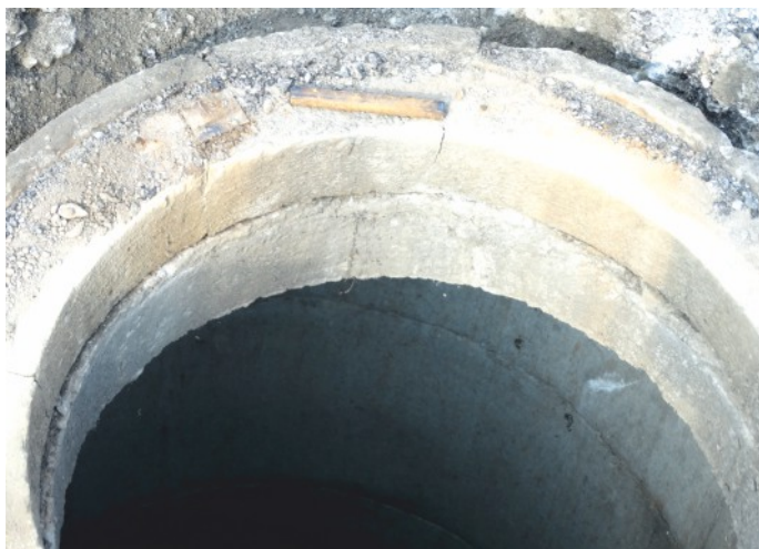
Degradace konstrukce podírající poklop. Kus výztuže jako vyrovnávací prvek způsobuje bodový destruktivní tlak.
