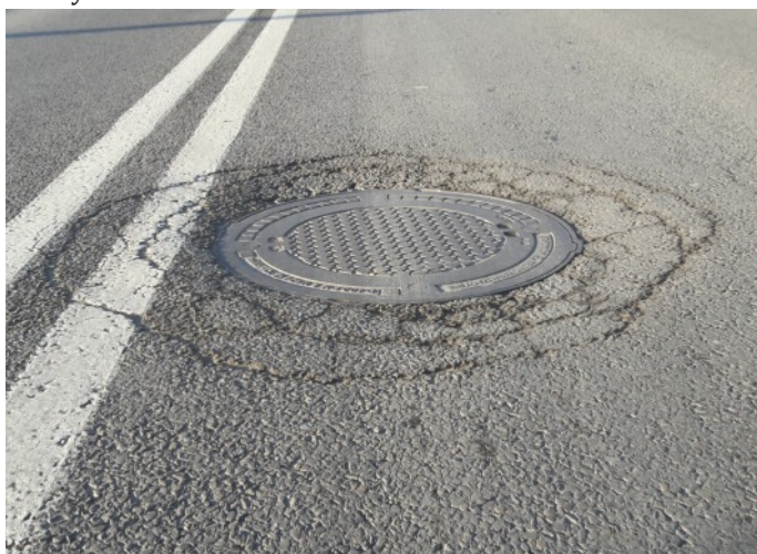
Poklop kanalizační šachty je umístěn přímo v linii pojezdu kola vozidla. Dopravní zatížení Kr. 2-3. Degradace podpůrných prvků poklopu, poškození základu a praskání povrchu vozovky. (Kr 2 – 13-70 pojezdů jízdního pruhu nákladními automobily se zatížením osy 100 kN za den, Kr 3 – 71-- 335 přejezdů za den, polské předpisy).
