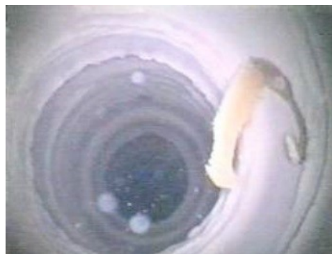
Potrubí přivádějící vodu na filtry za použití chlornanu sodného – výskyt biofilmu
