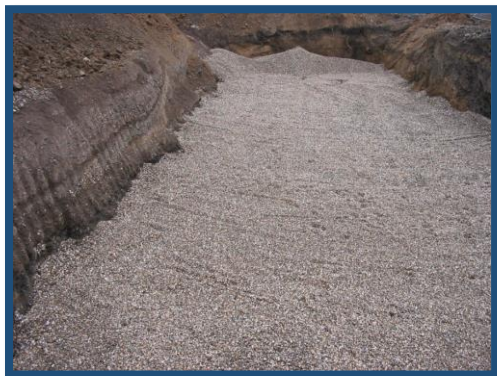
Nesprávně upravená základová spára
